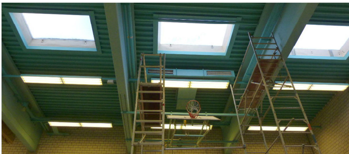
Abbildung 25: alte Hallenbeleuchtung in der Turnhalle des Erasmus-von-Rotterdam Gymnasiums
